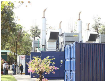
Tổ hợp phát điện dung biogas từ quá trình ủ rác
